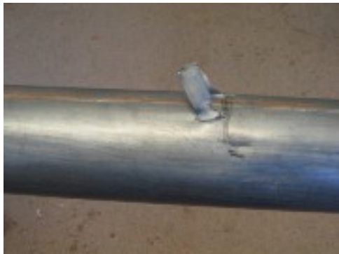
eine gerissene Haft
